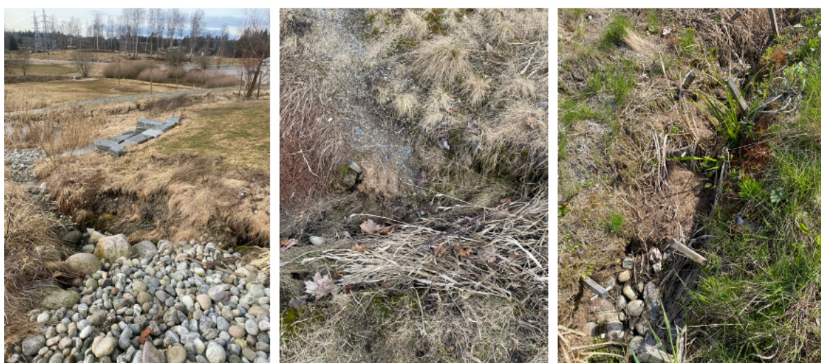
Figur 29: Utglidninger langs kanten av bekkeløpet i den konstruerte våtmarken ettersom vannet får for stor hastighet i helningen bak Veterinærbygningen. Foto: Nummelin, M.
