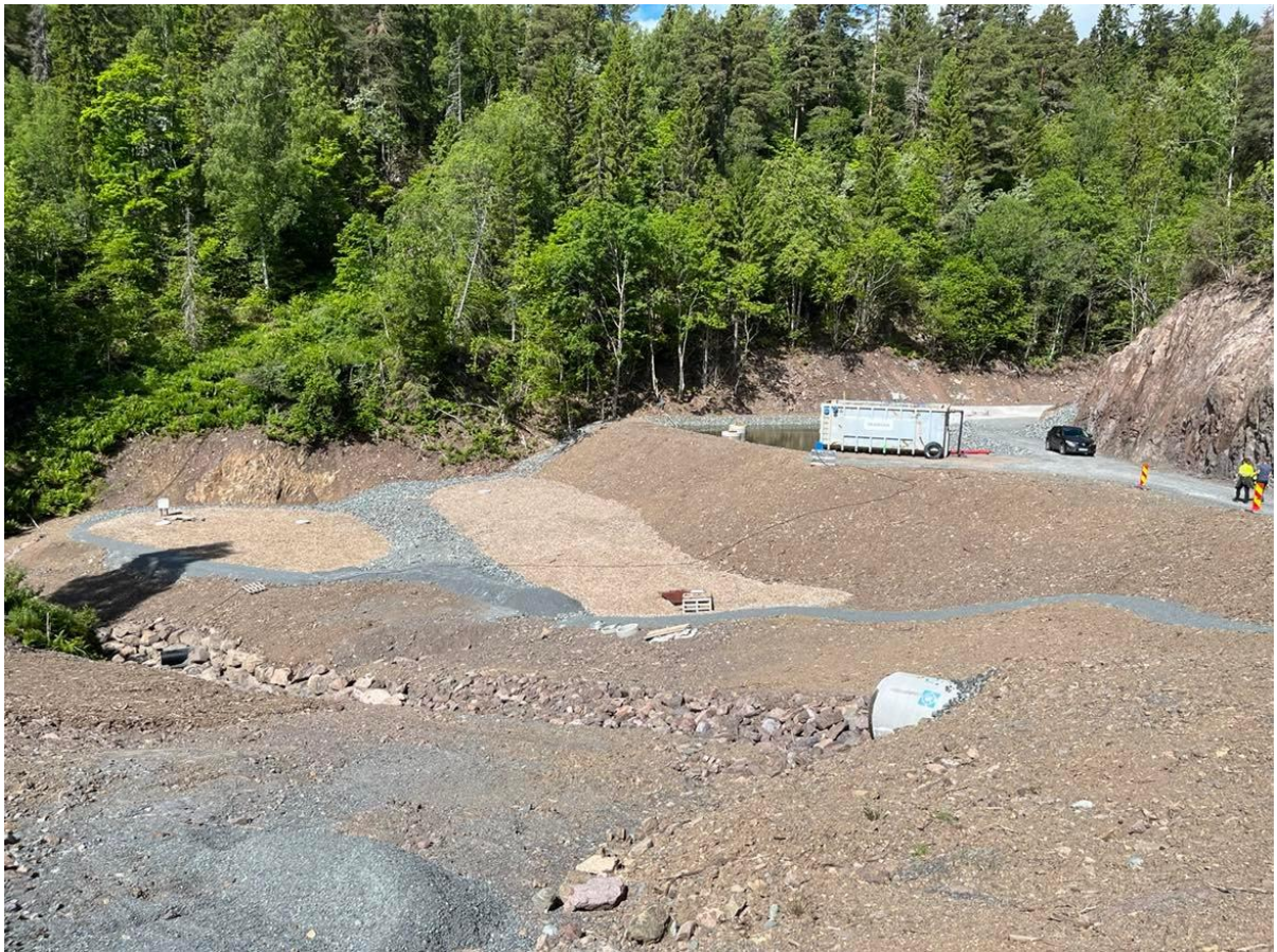
Figur 2. Bilde av renseanlegget (bilde, Magnus Evang).
