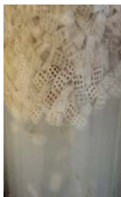
Figur 3.3: Biofilteret påvirket av maling.
