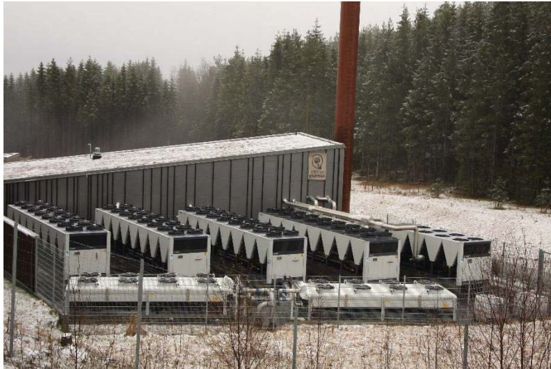
Figur 14: Bak fra høyre: KM2, KM3-6, foran: 2 tørrkjølere
