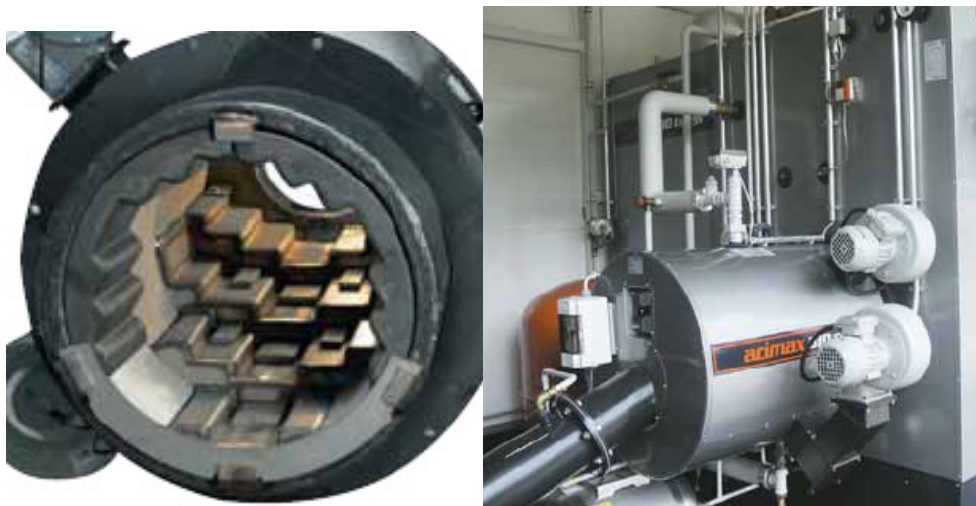
Figur 6. Bilde av Arimax Biojet innvendig, og montert mot en kjel (Kilde: Swebo 2006).
