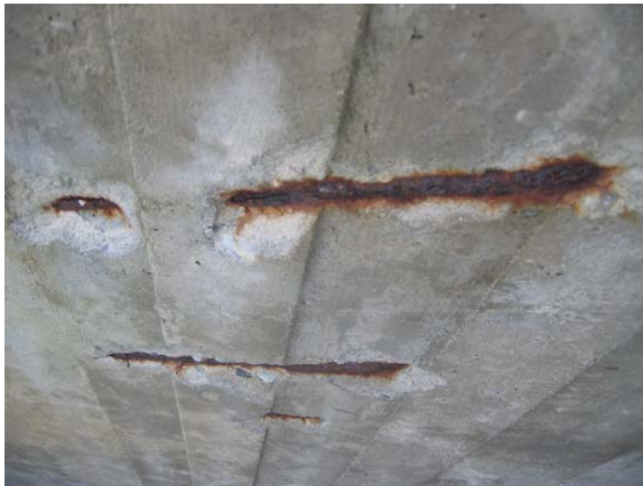
Bilde 23: Lite overdekning fører til korrosjon (Fredrik C. Løvenskiold 2006)
