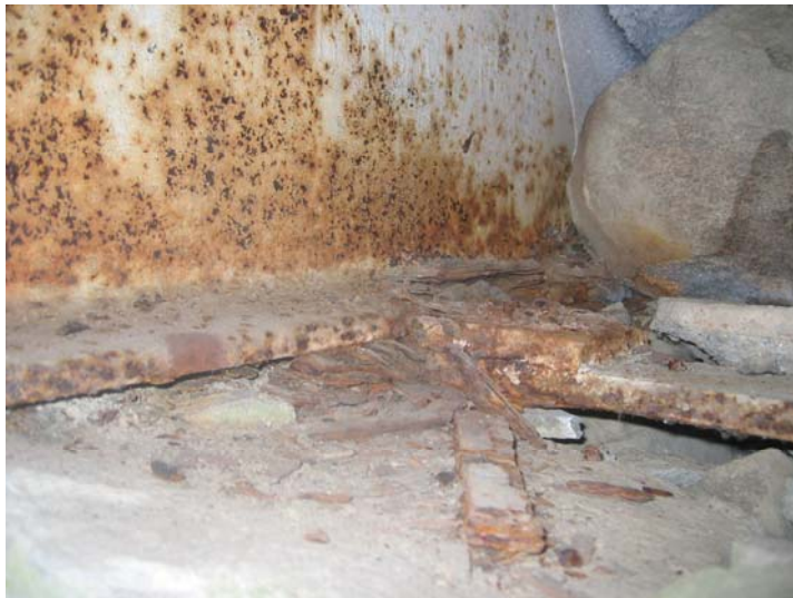
Bilde 3: Korrosjon som har oppstått i sveiseforbindelse (Fredrik C. Løvenskiold 2006)
