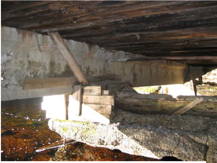
Bilde 12: Brokar i dårlig forfatning, sprekker og undergraving (Fredrik C. Løvenskiold 2006)
