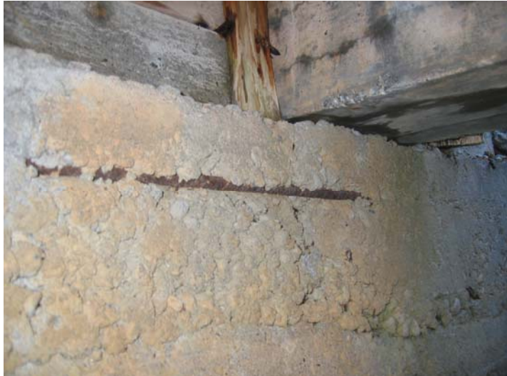
Bilde 5: Støpesår og for liten overdekning. Det resulterer i korrosjon på armeringen (Fredrik C. Løvenskiold 2006)
