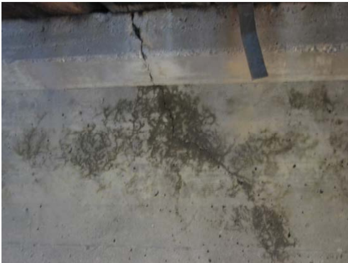
Bilde 13: Her er tydelige sprekker i de prefabrikerte betongbjelkene (Fredrik C. Løvenskiold 2006)
