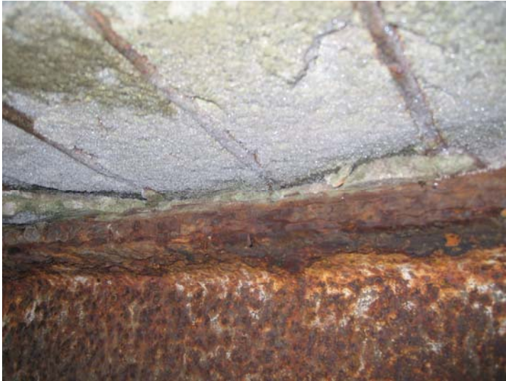
Bilde 19: Kraftig angrep av korrosjon på H – bjelkene (Fredrik C. Løvenskiold 2006)
