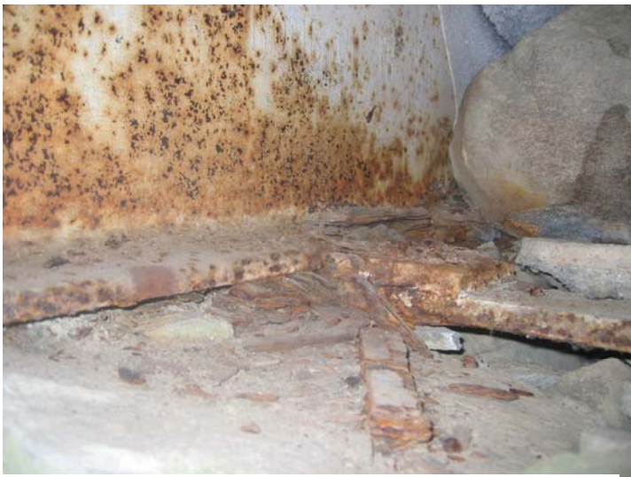
Bilde 20: Sveiseforbindelsene mellom H - bjelker og tverrstag er også preget av korrosjon (Fredrik C. Løvenskiold 2006)
