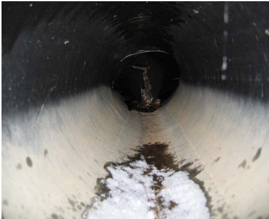
Bilde 2 viser en plastkulvert som har blitt punktert. Man kan se at det har vært en punktblastning der punkteringen har oppstått fordi kulverten ikke er sammentrykket.
