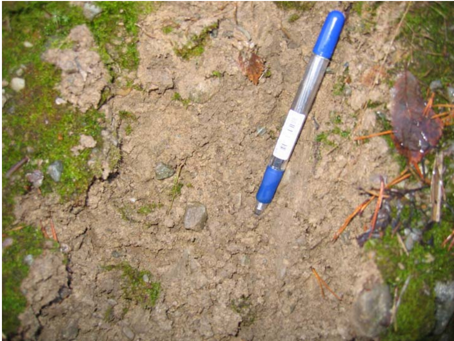
Bilde 5 viser massene som var benyttet i overbygningen over en betongkulvert. Massene hadde et stort silt innhold og kan karakteriseres som telefarlige.
