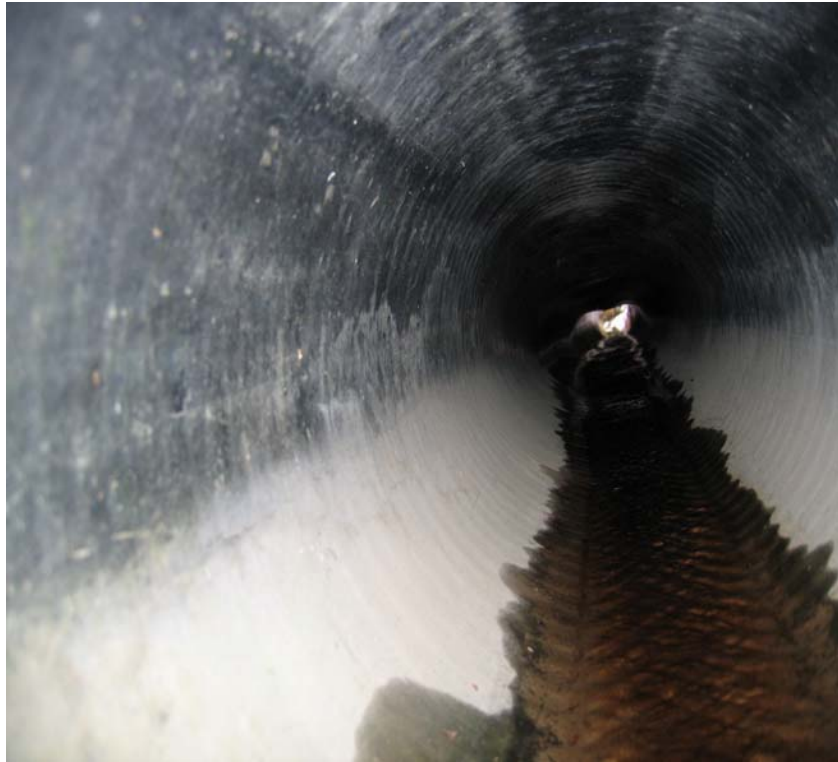
Bilde 1 viser en plastkulvert som er sammentrykket, man kan se dette ved å se at lysningen i utløpet ikke er rund, men sammentrykket eller oval.
