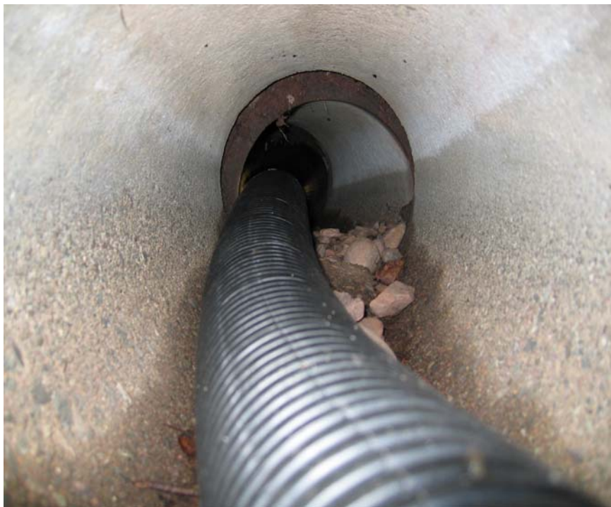
Bilde 3 viser en betongkulvert med tinerør som har glidd fra hverandre. Det er ikke vanskelig å tenke seg at denne kulverten transporterer mindre vann enn en som er hel.
