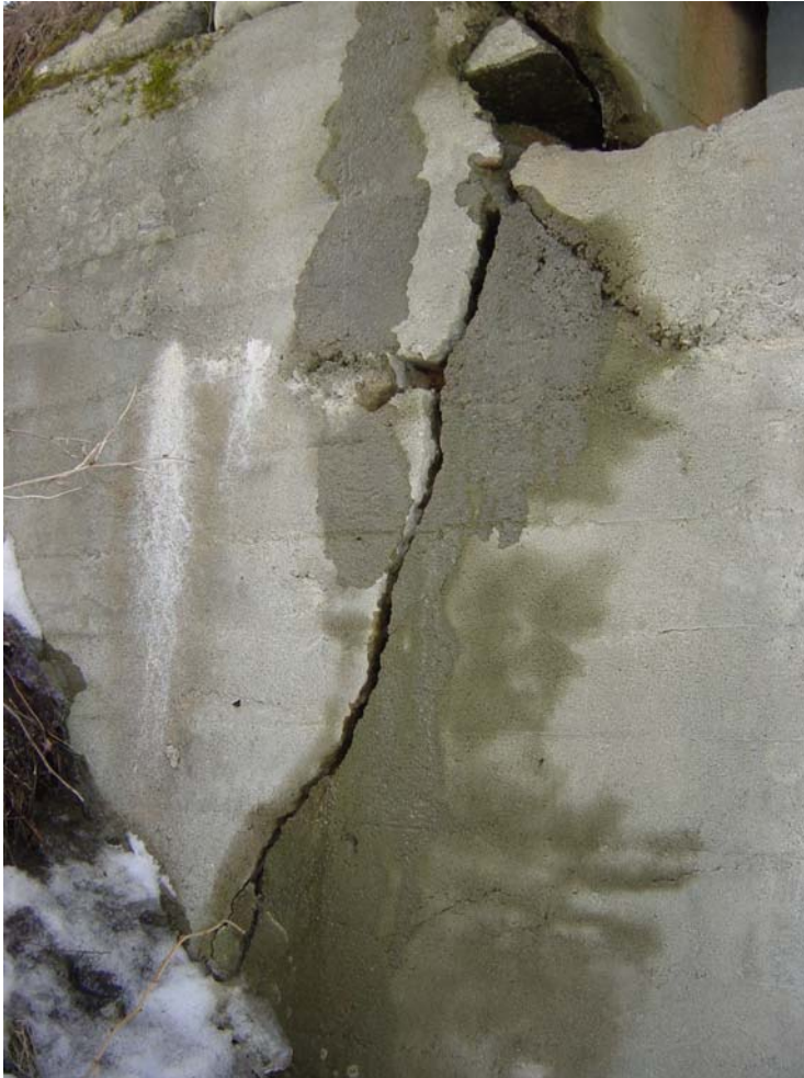
Bilde 3: Eksempel på sprukket brukar (Øvre Uvdal bru).
