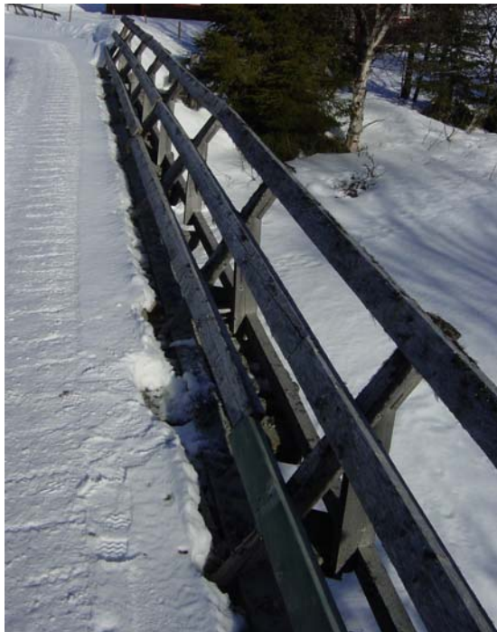
Bilde 1: Ikke godkjent rekkverk (Privat bru i "Borgemørkje").
